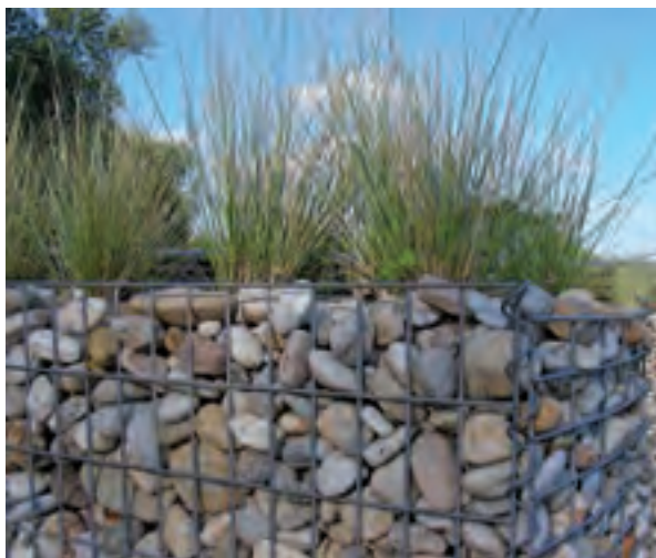
Gabionen aus Flußkieseln mit bepflanzter Krone – in naturnahen Anlagen den unbegrünten Varianten vorzuziehen
