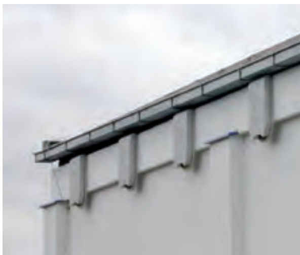
Vorgefertigte Fledermausbretter an einer Fassade, bevorzugt an einem ungestörten Ort und unter einem Dachvorsprung.
