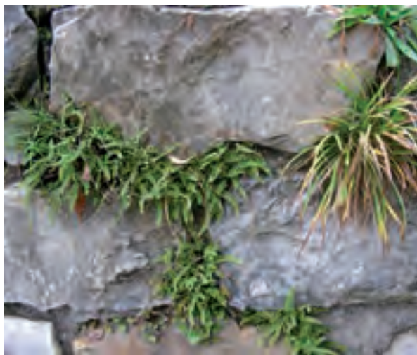
Mörtelgebundene Steinmauer. Die zurückgesetzten Mörtelfugen werden im Laufe der Jahre von genügsamen Pflanzen besiedelt.
